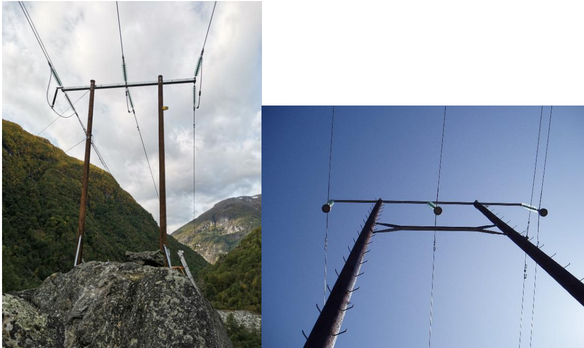
Foto: BM-master isolert for 132 kV (glassisolatorer erstattes av komposittisolatorer i dette prosjekt)
