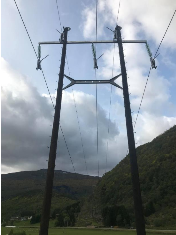
Fig. 3: 132 kV BMT-mast under lineutdrag med riegel-avstivning, og overliggende innføringsvern for mast 51 og 52 Tysse. (glassisolatorer erstattes av kompositisolatorer i dette prosjekt)
