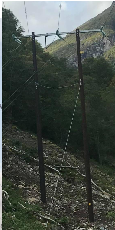
Fig.2 BMA bæremast 132 kV med underliggende OPGW som skifter side. (glassisolatorer erstattes av komposittisolatorer i dette prosjekt)
