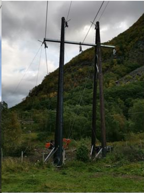
Fig.4: 132 kV FMT kabelendemast som planlagt Tysse med overliggende innf.vern mast 53 (under lineutdrag) (glassisolatorer erstattes av kompositisolatorer i dette prosjekt)
